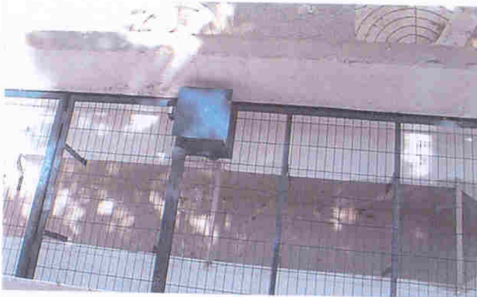
- Ojo de Gilena (Gilena). Canal de 9" con caseta de protección del vaso comunicante y rejilla de protección del canal.
