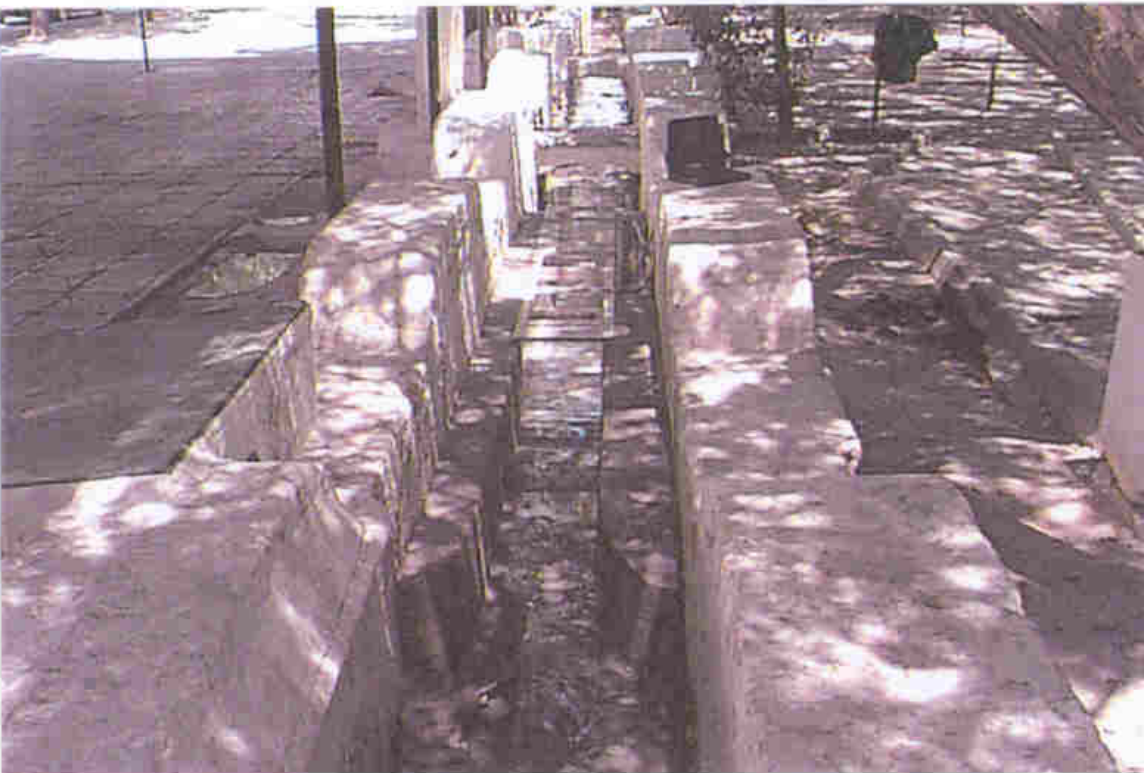
- Fuente de Lora de Estepa (Lora de Estepa). Canal de aforo de 9".
