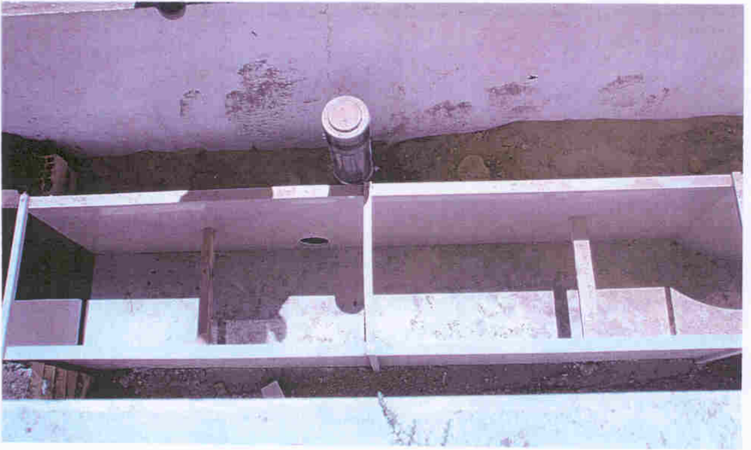
- Ojo de Gilena (Gilena). Canal de 9" con vaso comunicante para la instalación de "datalogger" (MDS-Floater).
